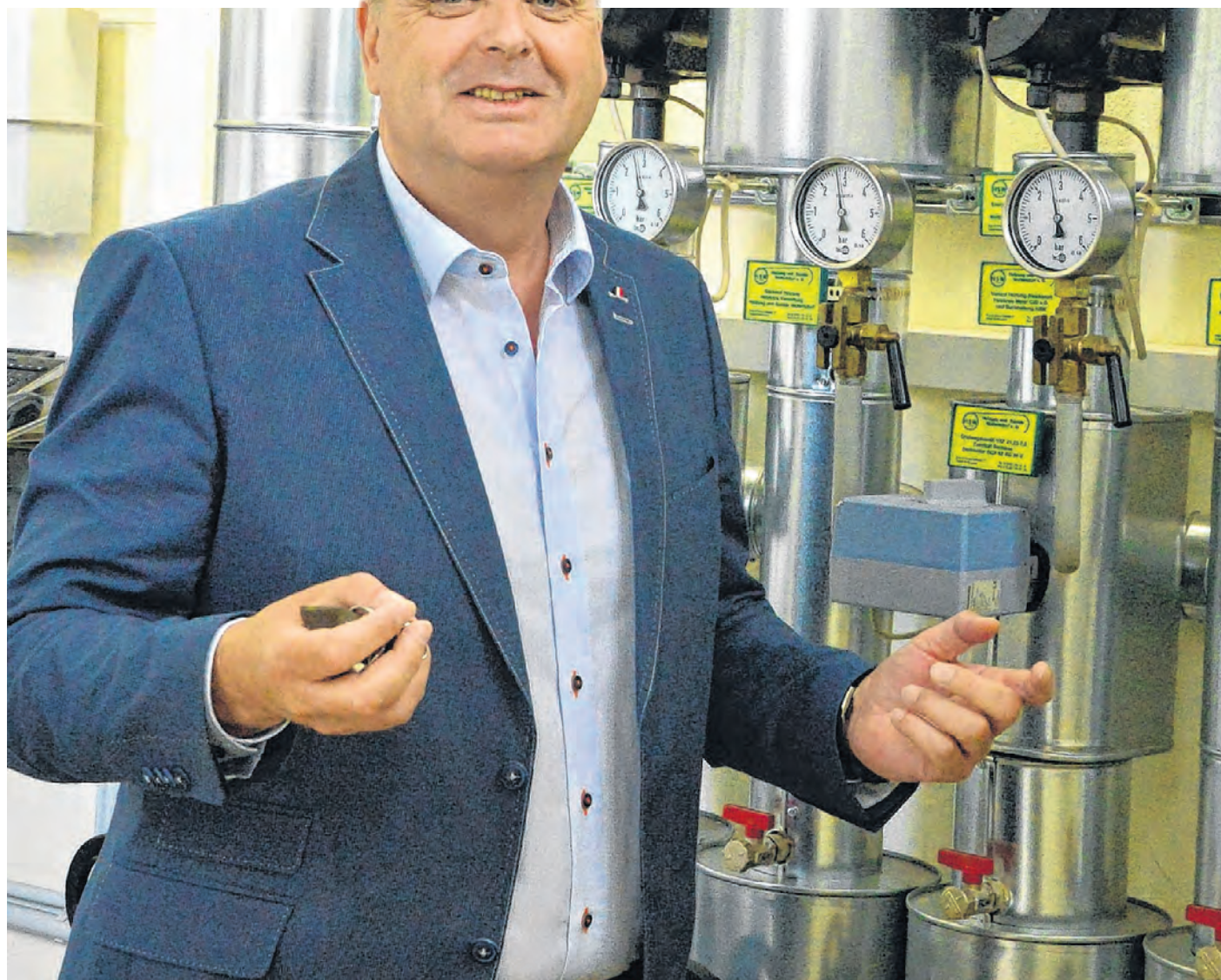
Vorzeigebild: Michael Gürtler, Vorstandsvorsitzender der Heizung und Sanitär Woltersdorf e.G. (HSW), erläutert Besuchern gerne die Technik im Heizhaus auf dem Firmengelände in Woltersdorf (Oder-Spree) nahe der Berliner Stadtgrenze. Foto: MOZ/Bettina Winkler
