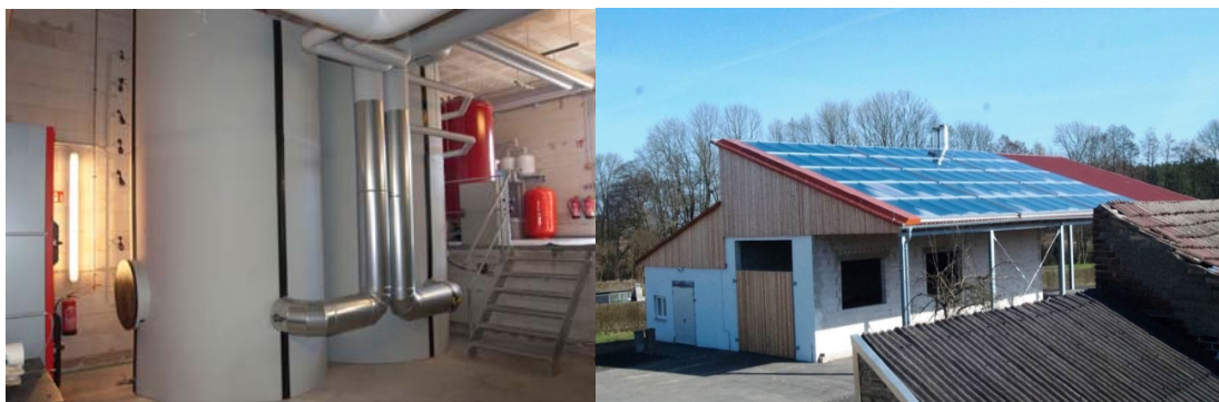
Heizhaus: Speicher und Solarthermie-Außenanlage
