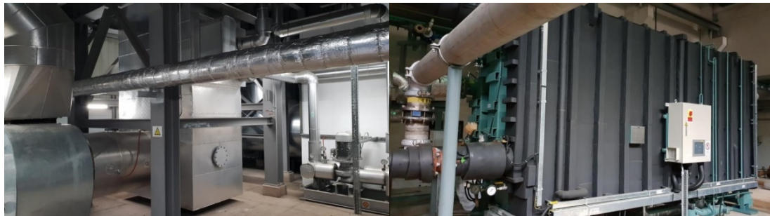
Bild links: Wärmetauscher; Bild rechts: Kältemaschine Bildquelle: Glasmanufaktur Brandenburg GmbH
